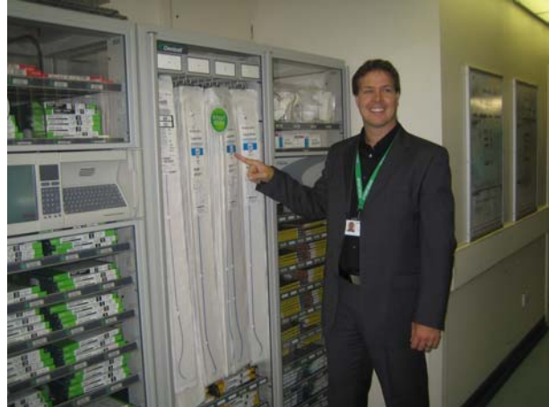
Wayne Fourie, Project Manager im St. Thomas's beschreibt die Wirkungsweise der Schranksysteme.
