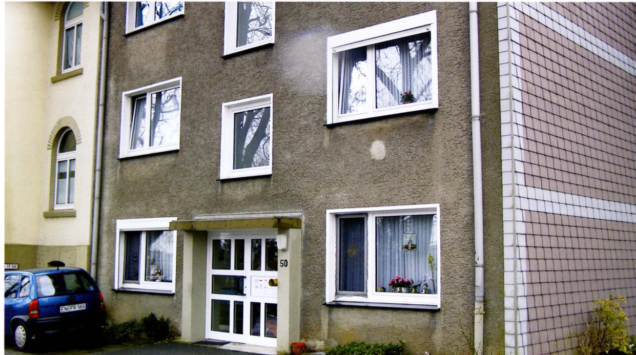
In diesem Jahr ein Schwerpunkt für Modernisierung und Instandhaltung: Die Häuser an der Waldstraße.
